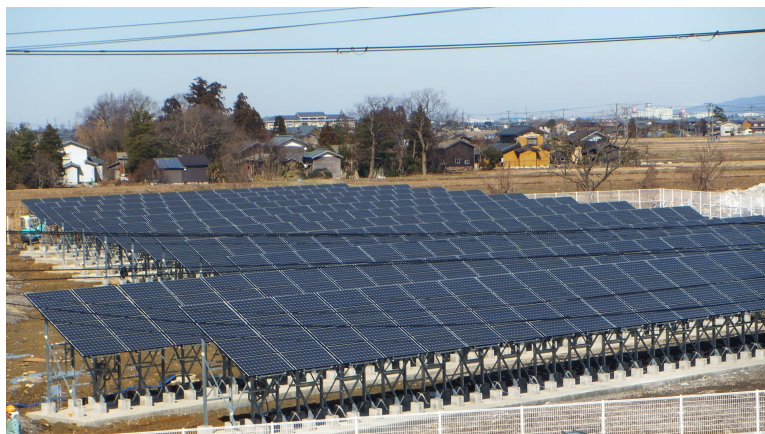
太陽光発電設備
